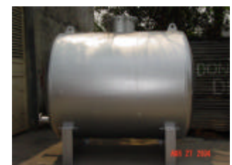
MS CONDENSATE TANK
